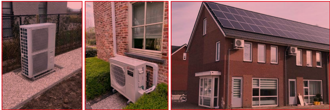
Zo niet: installaties, in het zicht vanaf de openbare ruimte, op het erf of aan de gevel
